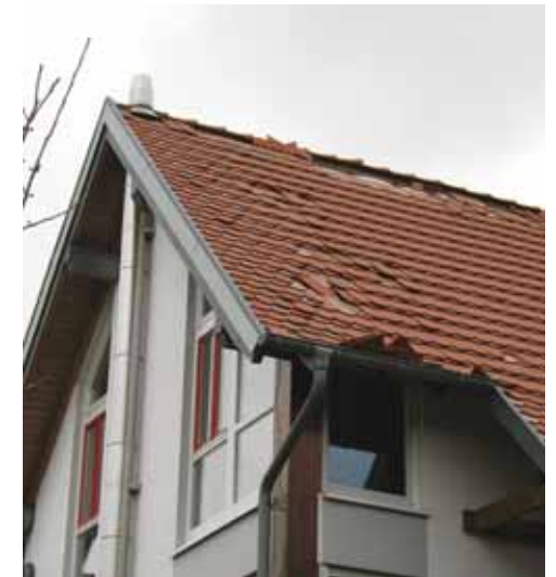
Schwere Stürme können selbst Dachziegel lockern, die dann zur Gefahr werden. Foto: VPB
