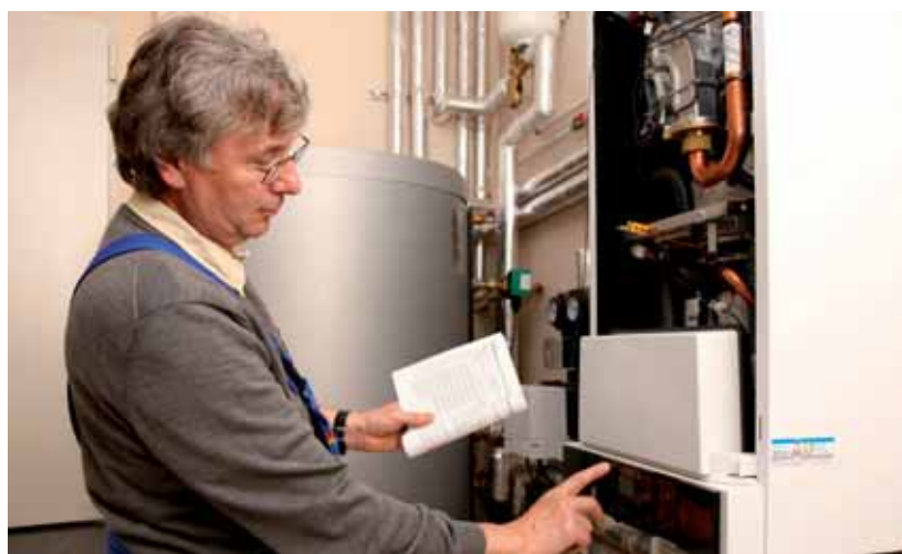
Eine moderne Heizungsanlage hilft gegen steigende Energiekosten: Installateur bei der Einstellung einer modernen Heizung. Foto: BDH e.V./akz-o
